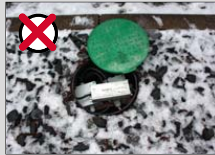
Netzteil ungeschützt im Bodenschacht Power supply unprotected inside the ground shaft Source d'alimentation sans protection dans un puits au sol
